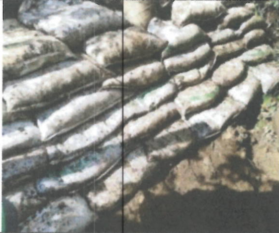
Foto N°11 Trincho en sacos de suelo cemento para contención lateral de tubo Finca San Antonio
