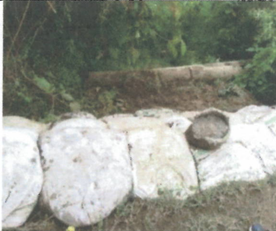
Foto N°12 Trincho en sacos de suelo cemento para contención lateral de tubo Finca San Antonio con columneta en concreto simple
