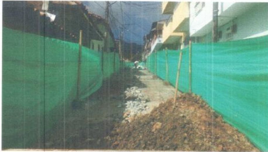
CERRAMIENTO PERIMETRAL CON YUTE
