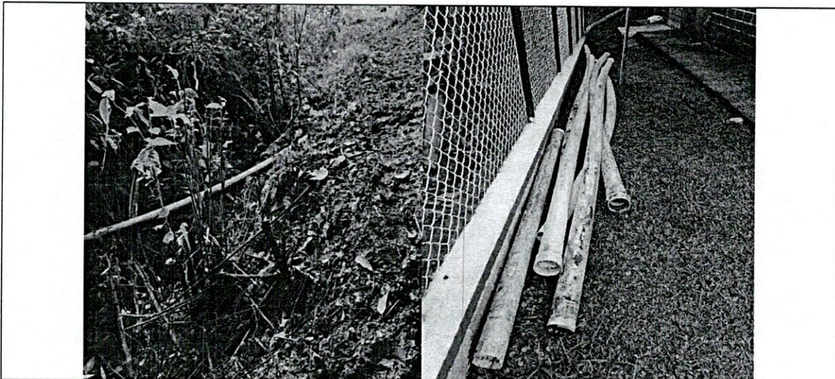
Imágenes 1 y 2. Tubería PVC afectada con el movimiento del terreno
