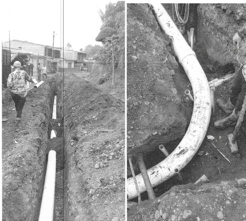
Tubería y anclaje de codo de gran radio
