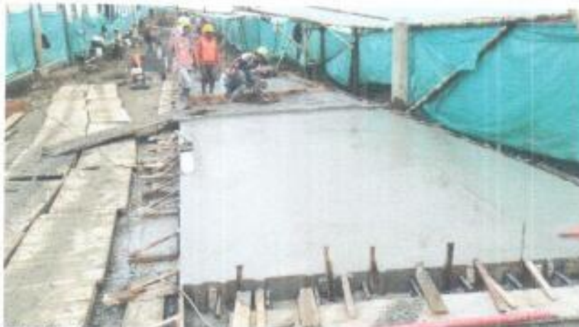
Foto 19. Vaciado de concreto losas de pavimento No. 16, 17 y 18. Carrera 3 Calles 10 a 9A.
