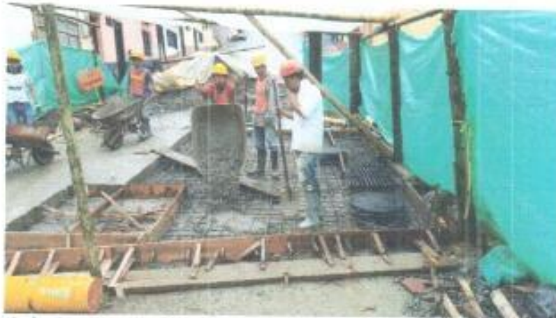
Foto 18. Vaciado de concreto losa de pavimento No. 15. Salida Calle 10 a esquina Carrera 3.
