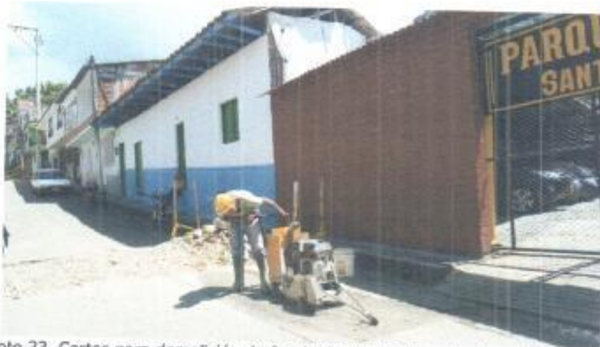
Foto 33. Cortes para demolición de franja de pavimento entre las calles 9A y 8.
