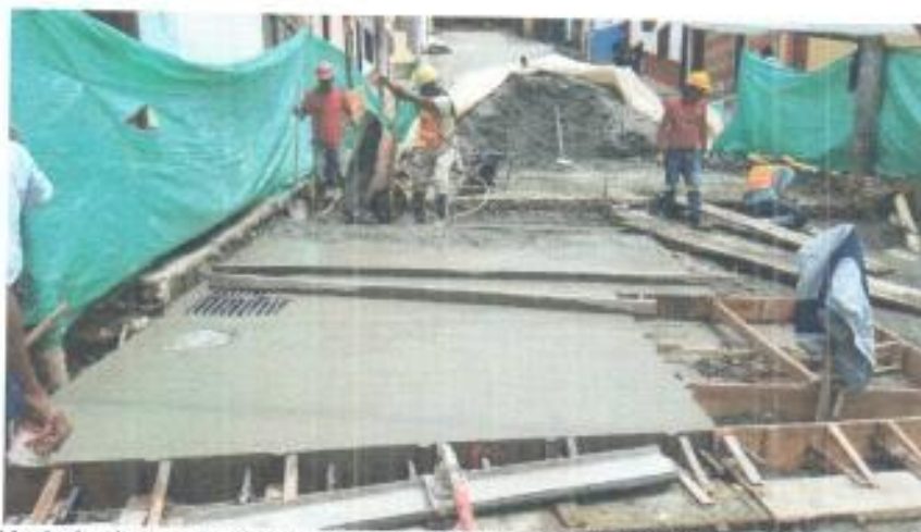
Foto 15. Vaciado de concreto losa de pavimento No. 15. Salida Calle 10 a esquina Carrera 3.
