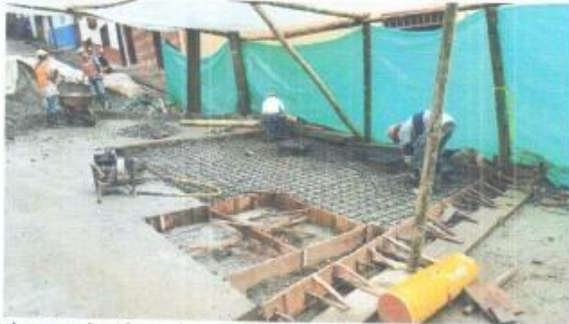
Foto 17. Armado acero de refuerzo losa de pavimento No. 14. Salida Calle 10 a esquina Carrera 3.
