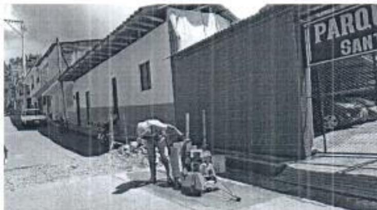
Foto 14. Cortes para demolición de franja de pavimento entre las calles 9A y 8.
