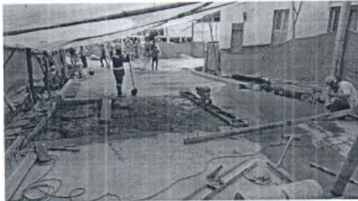
Foto 7. Acero de refuerzo y vaciado de concreto losa No. 22, sobre la cámara No. 4A del Box Couvert y el pozo de alcantarillado No. 2 (alcantarillado lado Derecho Aguas arriba).
