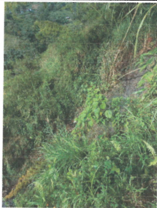
Fotografía 3. El escarpe de la ladera que coincide con el pie del deslizamiento es un macizo rocoso de esquistos negros, blando y fracturado. Las pendientes del talud, casi verticales son generadas por la socavación de fondo por las aguas de la alcantarilla de la banca de la vía del ferrocarril.
