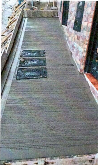
FOTO 15. Cajas para medidores (Cr 8 CI 2 y 3).
