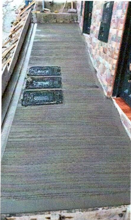
FOTO 15. Cajas para medidores (Cr 8 CI 2 y 3).
