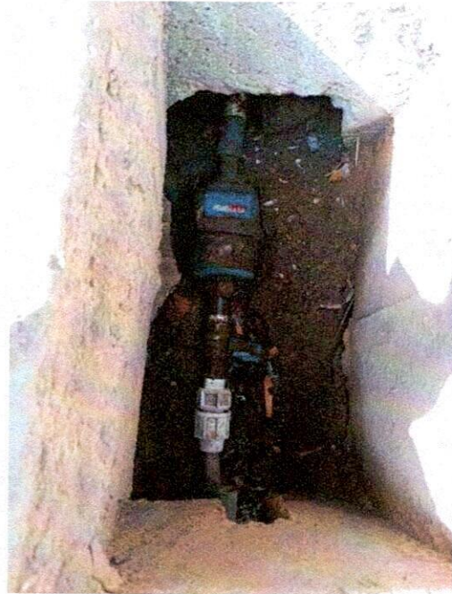
FOTO 14. Cajas para medidores (Cr 8 CI 2 y 3).
