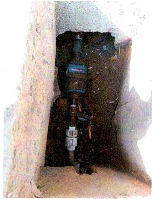
FOTO 14. Cajas para medidores (Cr 8 CI 2 y 3).
