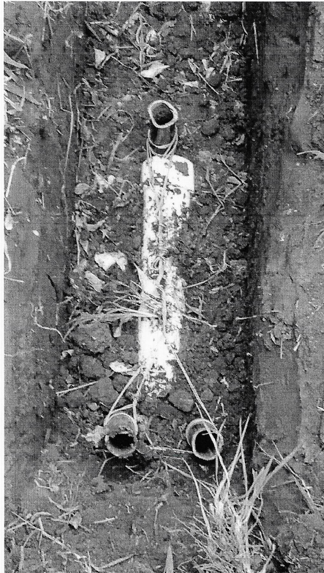
TAPON Y ANCLAJE K 1 + 746 FIN ETAPA I ACUEDUCTO
