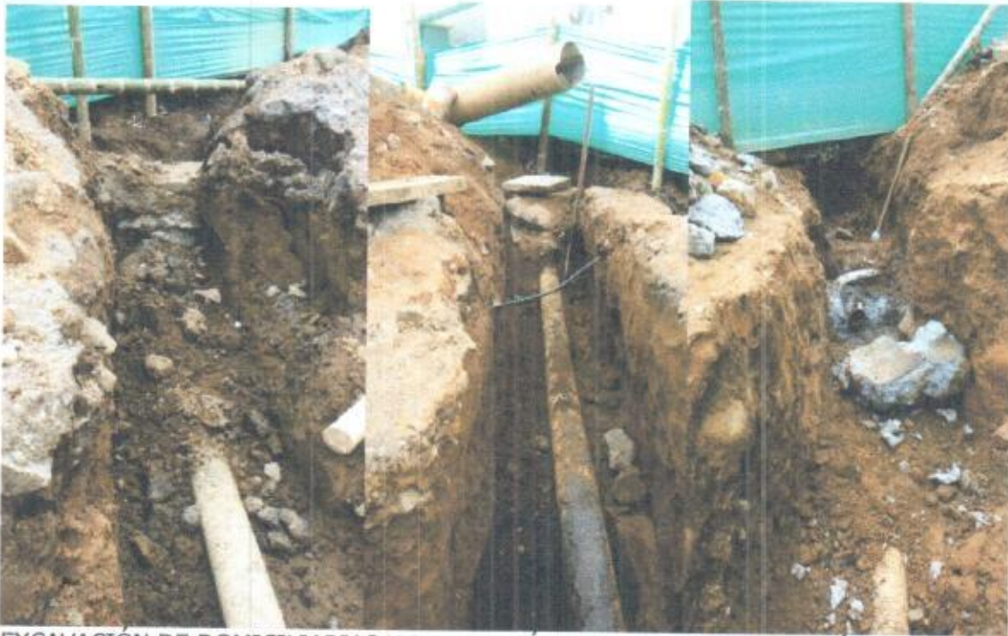
EXCAVACIÓN DE DOMICILIARIAS Y DEMOLICIÓN DE CAJAS DE INSPECCIÓN EXISTENTES EN EL EJE DE LA VIA.
