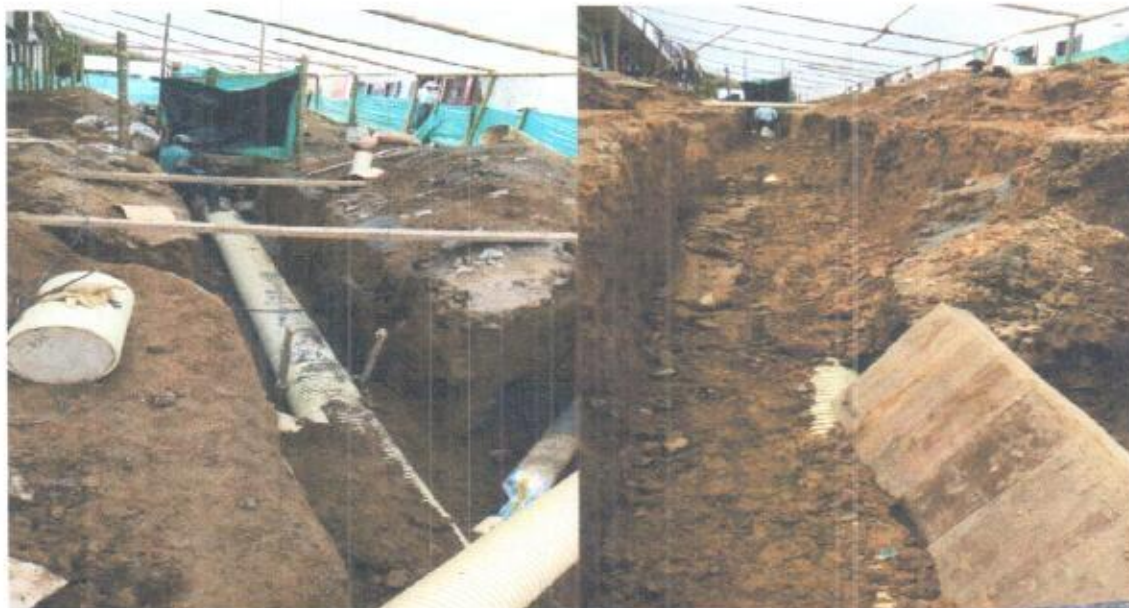
Foto 9 instalación de tubería principal hasta la cámara media. Llenos con material del sitio.
