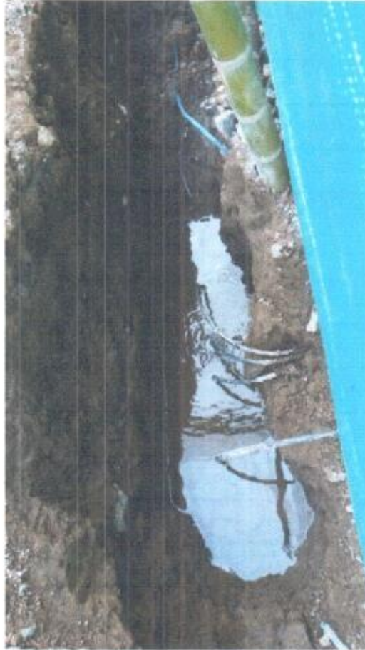
Fotos 14, aguas de acueducto.
