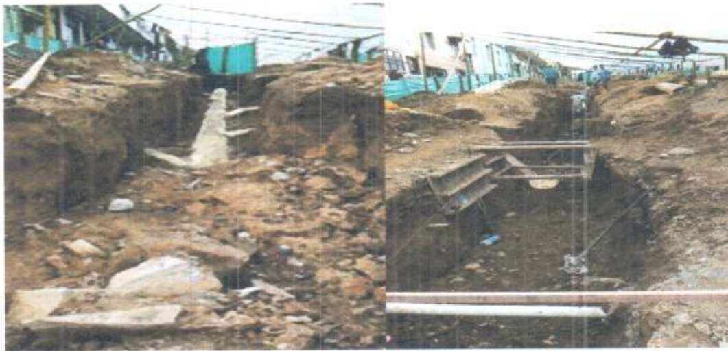
Foto 6 se continua con excavación de tubería principal y domiciliarias, desalojo de la tubería antigua.
