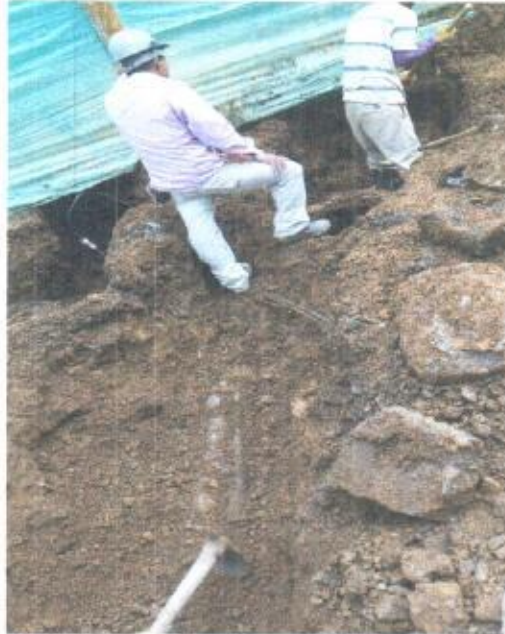
Foto 12 cajas domiciliarias con mas de una domiciliaria
