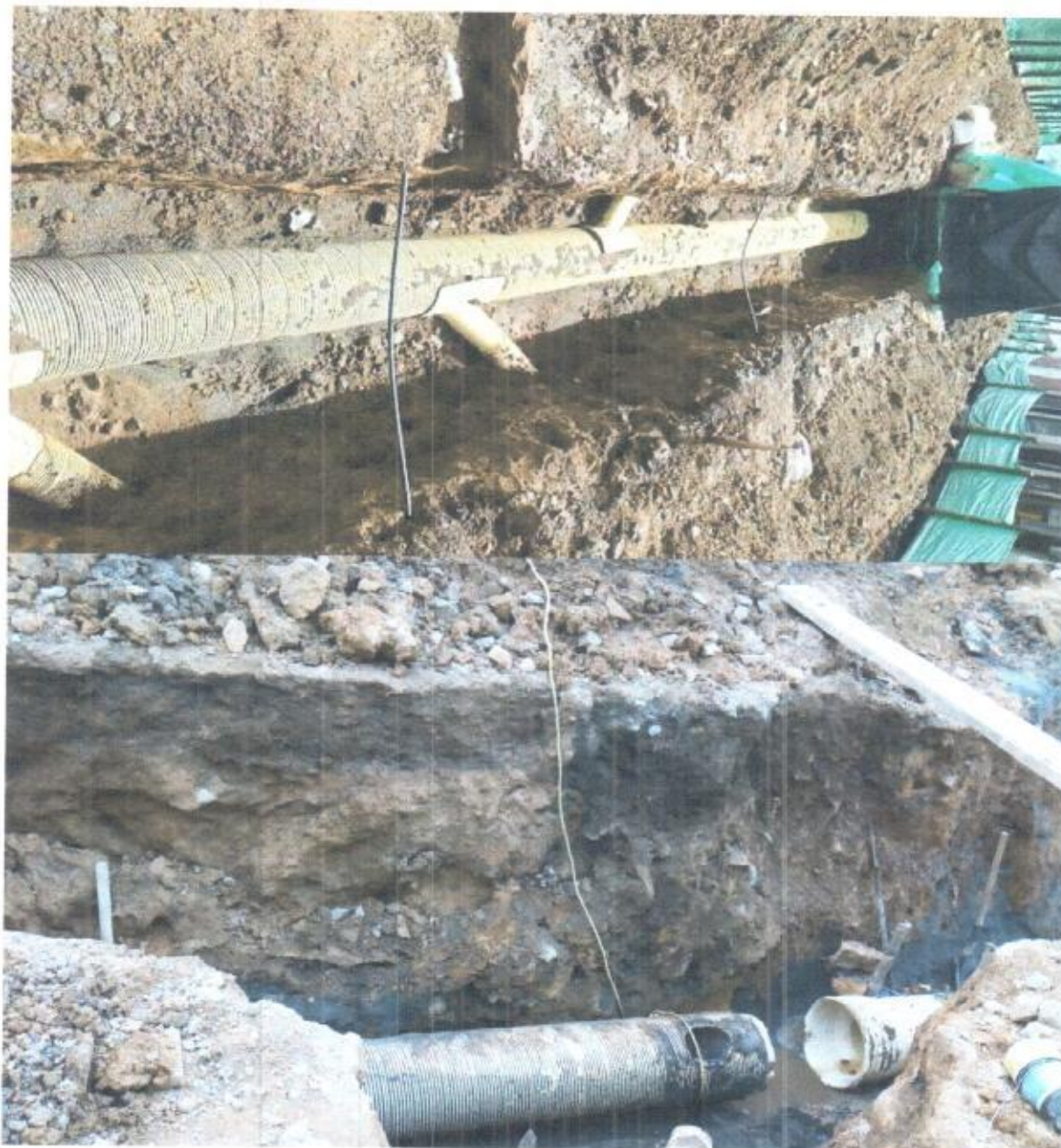
EVIDENCIA DE MALA CONDICION DE LA TUBERIA Y MALA INSTALACION.
