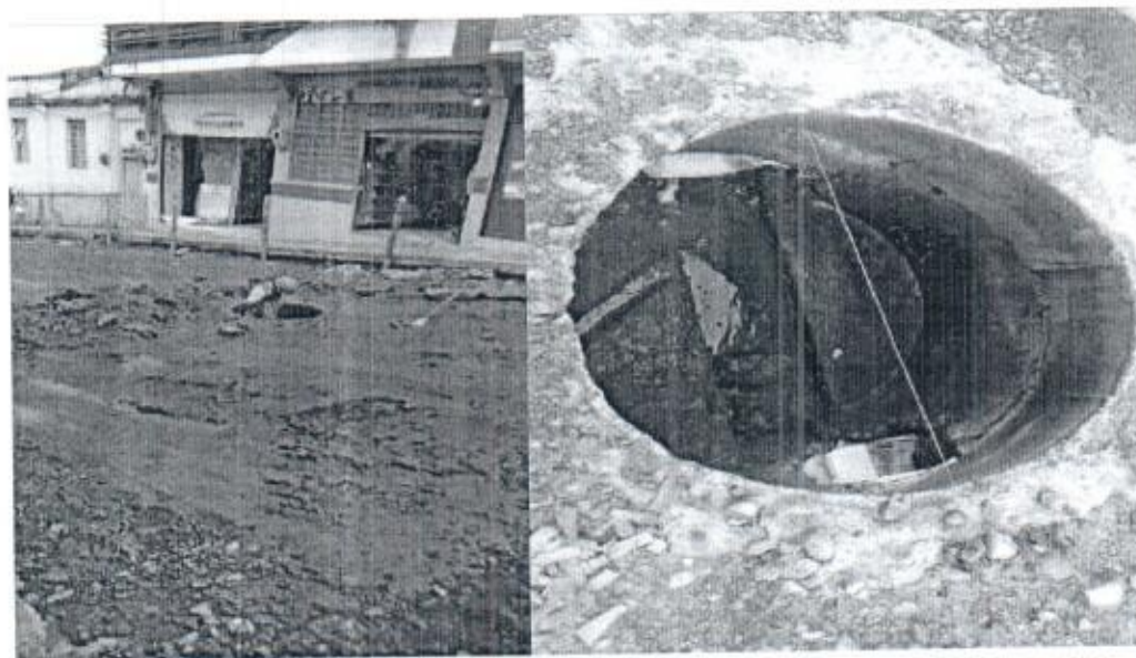
INSPECCION DE TUBERIA,SE EVIDENCIA QUE EL EJE CENTRAL DE LA TUBERIA ESTA DESALINEADO.
