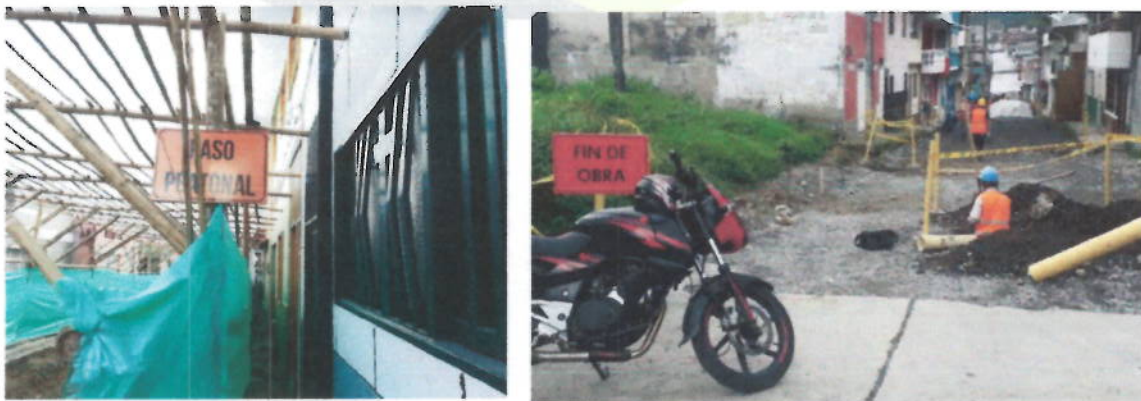
Señalización reglamentaria verticales en lámina soportada en base de concreto
