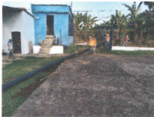
TERMOFUSION Y TRANSPORTE DE LA TUBERIA DE POLIETILENO EN TODA SU LONGITUD
