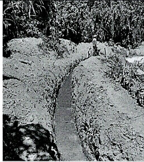
Foto 10: Cama de arena tapando el tubo en su totalidad
