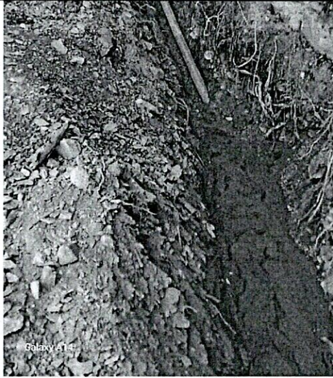
Foto 9: Cama de arena tapando el tubo en su totalidad
