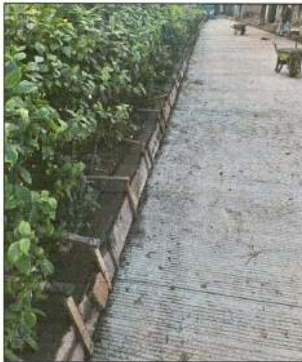
INP-06. Suministro, transporte e instalacion sello de junta de pavimento rigido 5 mm
