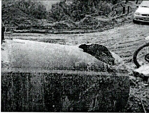
Imágenes 1. Tubería en polietileno de 10" perforada por retroexcavadora
