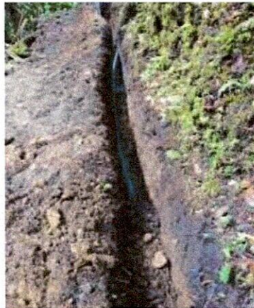
Foto No. 17: tubería polietileno de alta densidad PE- 100 PN 10 de 63 mm.
