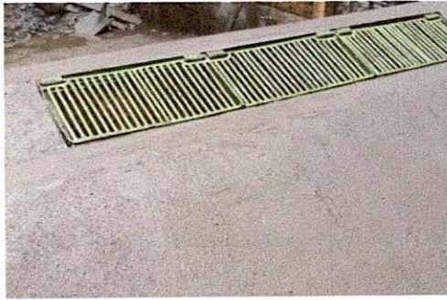
Foto No. 42: REJA METÁLICA DE 180X30
