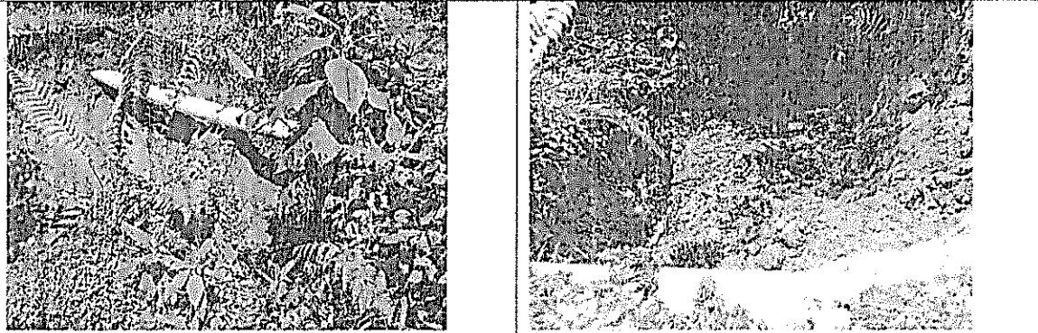
Deslizamiento que deja la tubería expuesta
