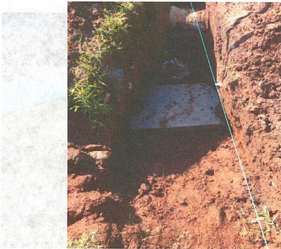
Caja de inspección de 0.8*0.8 con tapa
