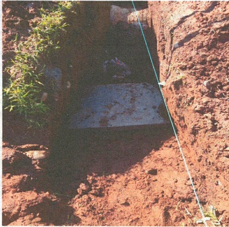
Caja de inspección de 0.8*0.8 con tapa
