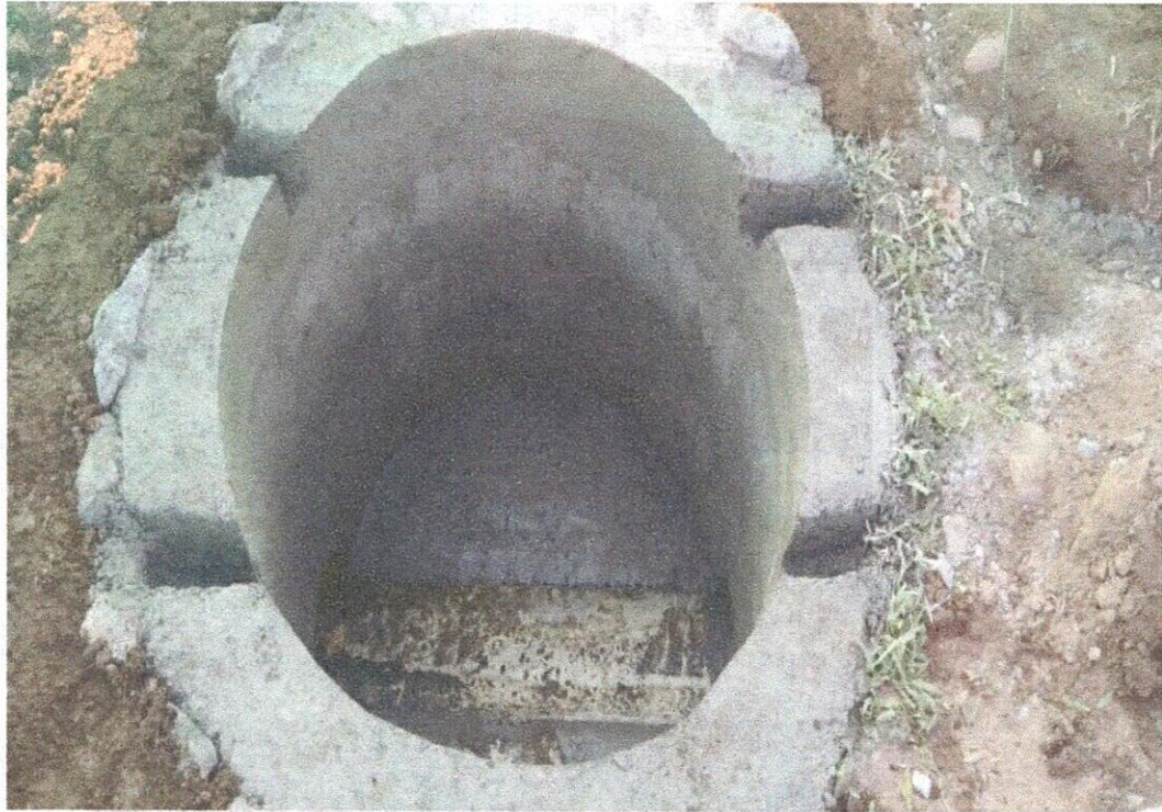
Cámara de Inspección con su respectiva base y cañuela
