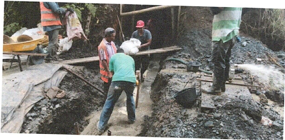
BOMBEO AGUAS PASO SUBFLUVIAL
